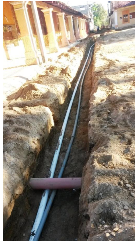
(Cableado subterráneo TELMEX)
