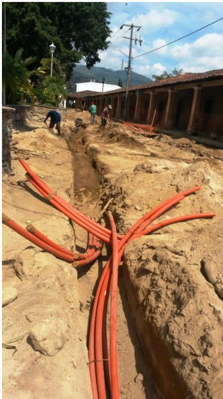
(Cableado subterráneo CFE)
