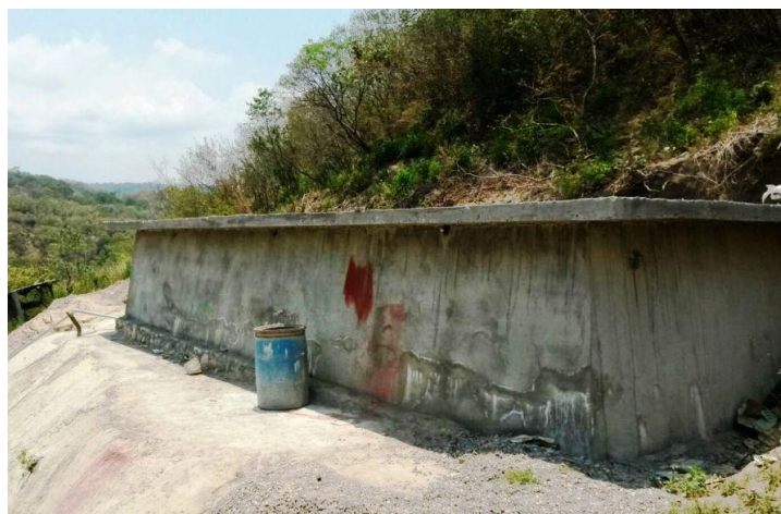
Tanque de agua potable Emiliano Zapata
