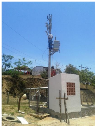
(Electrificación Pozo profundo Malpaso)
